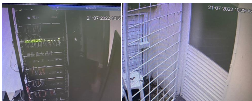
Imagem 36 – Imagens das câmeras de vigilância da UBS Centro (interna e externa)
